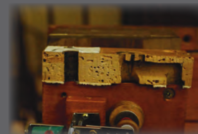
Les dégâts de la vermine
