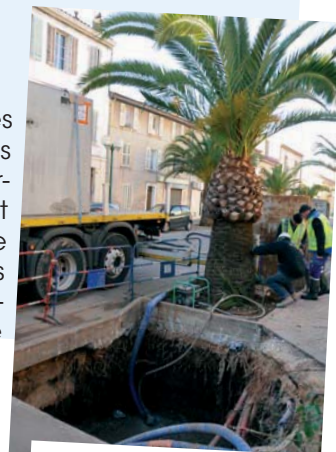
Trois ensembles de deux bacs jalonnent la rue Sadi Carnot d'ici la fin du mois.
