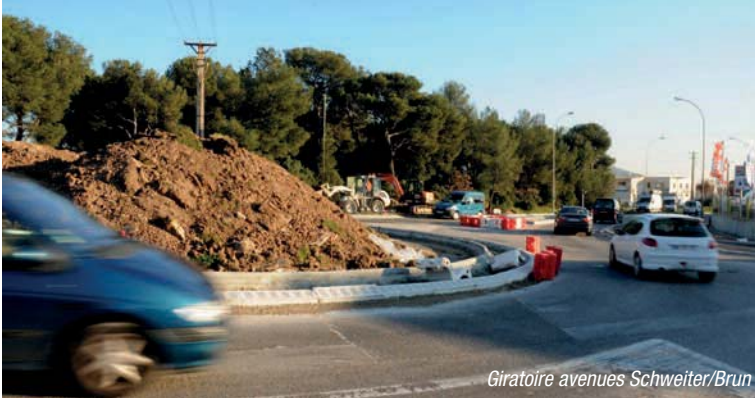
Le rond-point Marc Delage créé en 2009 est un exemple de réussite : il allie sécurité et espace vert méditerranéen
