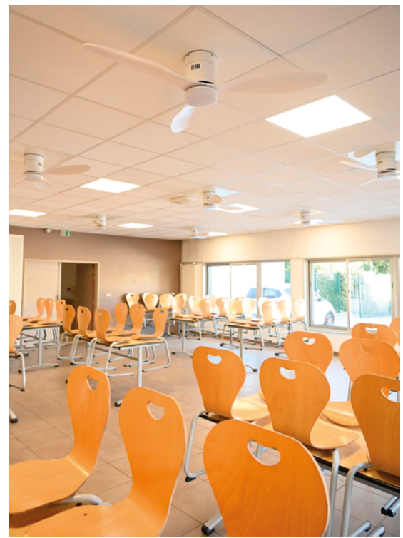
▲ Mise en place de 17 brasseurs d'air pour rafraîchir le réfectoire : plus efficace et économique.
